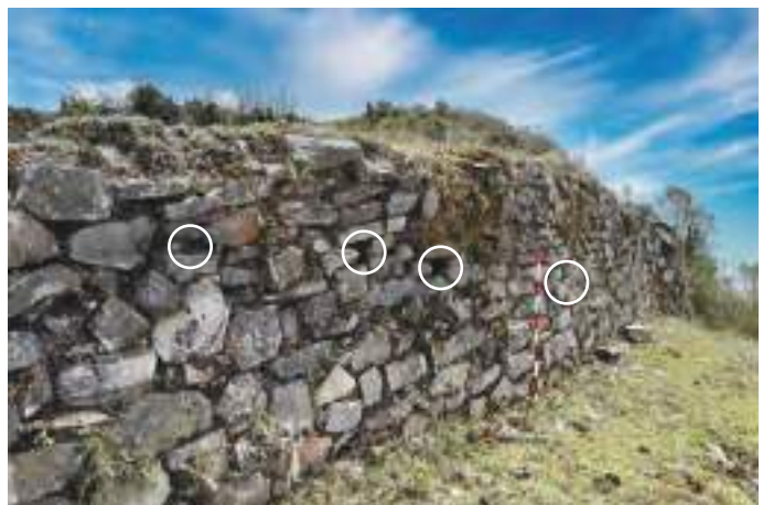
Foto 4. Detalle de los drenajes subterráneos para evacuar las aguas de la plataforma central del usnu de Platerirayoq.
